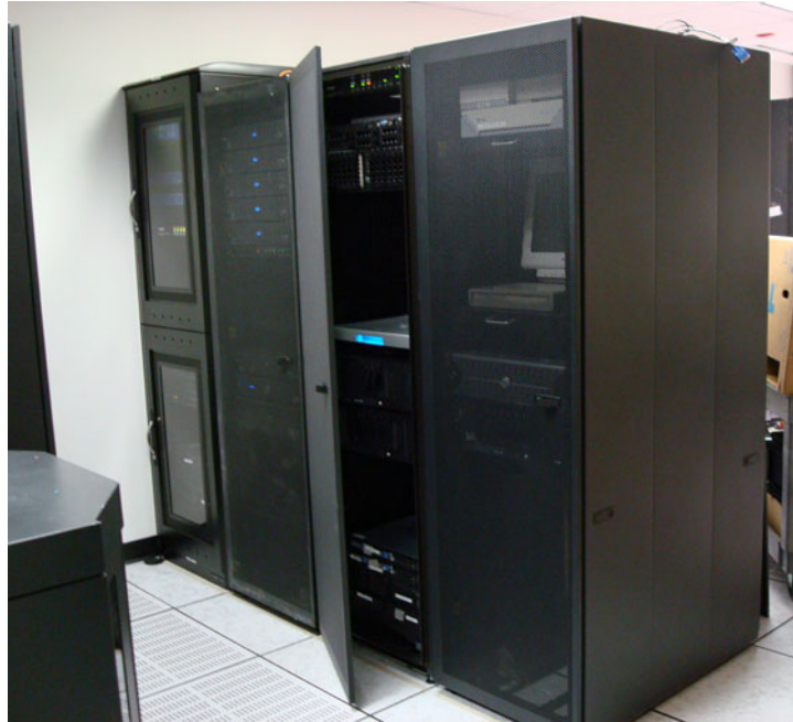
Exemple d'armoires verrouillables pour serveurs
